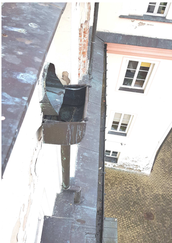
fot. Nr 18 Wylot żygacza i kosz spustowy w elewacji południowo-wschodniej-
