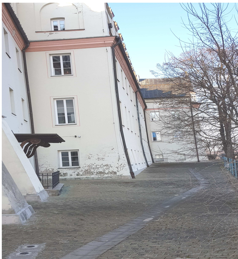
fot. Nr 6 Elewacja południowo-wschodnia - degradacja tynku przy cokole
