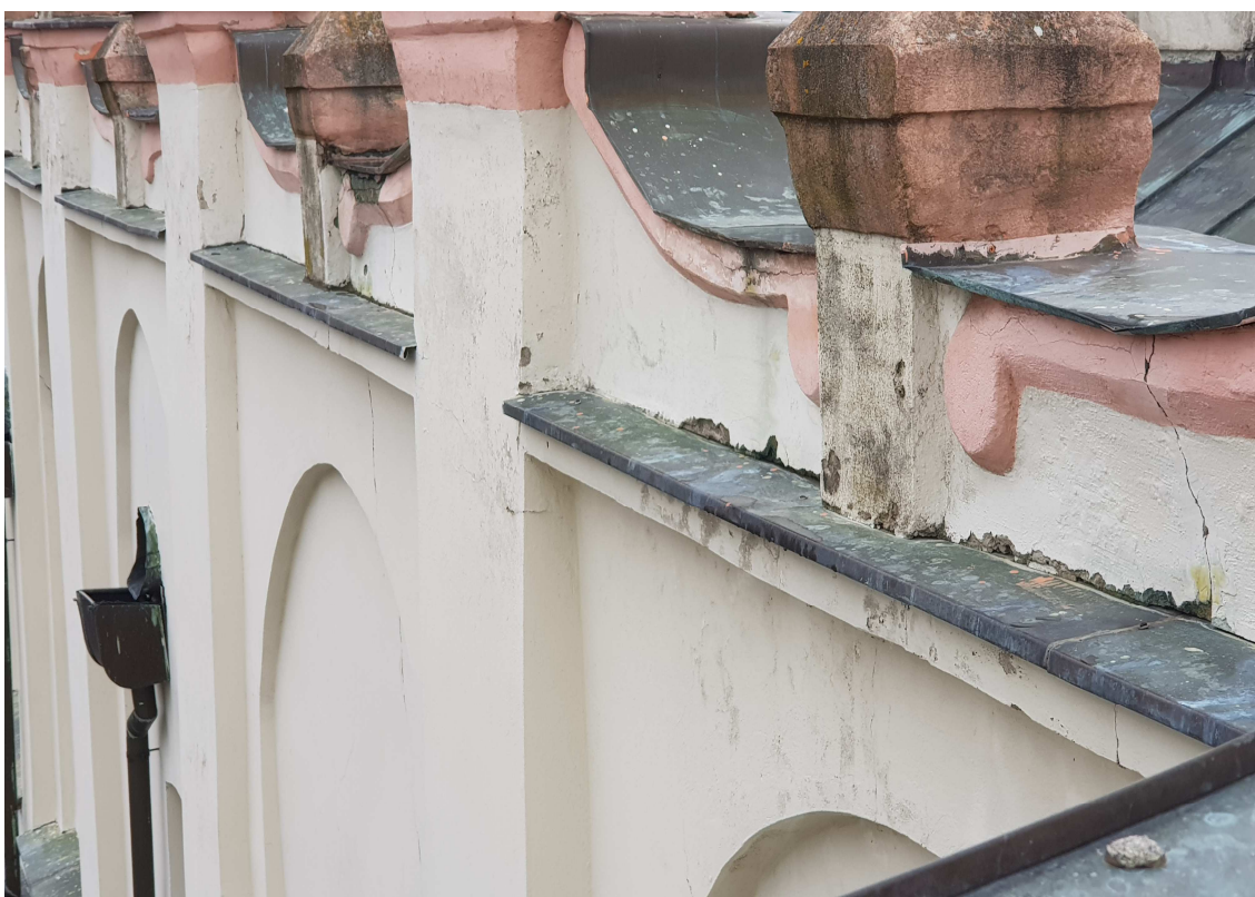
fot. Nr 8 Stan degradacji tynków attyki w elewacji południowo-wschodniej
